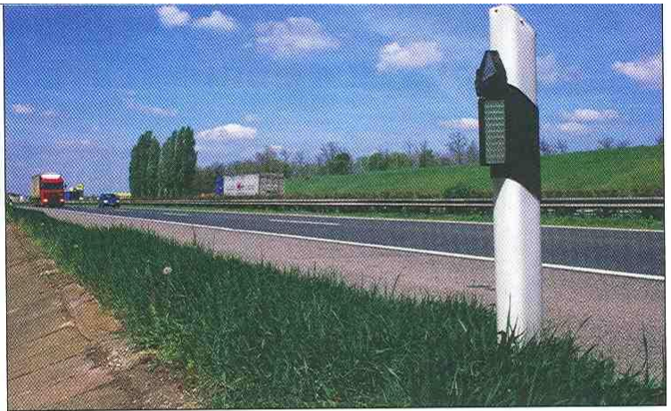
Vezetőoszlopra szerelt közúti optikai és akusztikus vadriasztó
